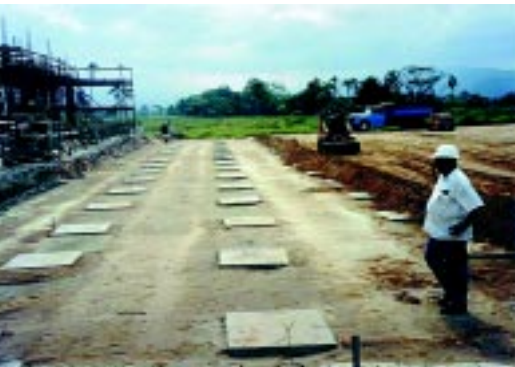
Detalhe do reaterro sobre capitéis, reaterro este que servirá de fundação direta para a laje de fundo dos decantadores
