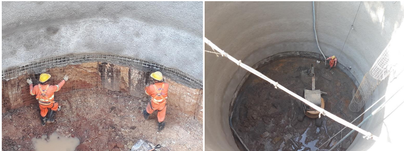
Figura 6: Etapas de construção do poço, (a) instalação da armação antes da concretagem, sendo possível visualizar a estaca cravada e (b) escavação no trecho de transição entre solo e rocha. (Fonte: ATO GeoCompany)
