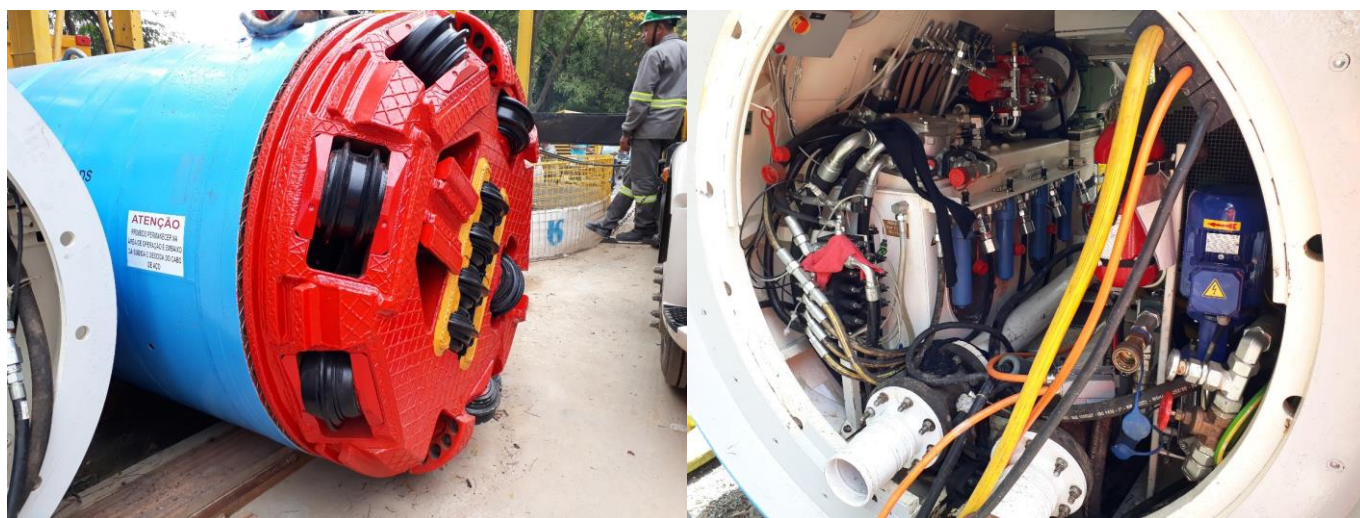
Figura 1: Equipamento utilizado na escavação do túnel, vista da cabeça de corte (a) e interna (b). (Fonte: ATO GeoCompany)
