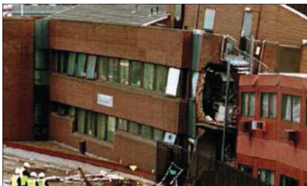
Colapso de edifício, posteriormente ao colapso dos túneis de Heathrow (1994)
