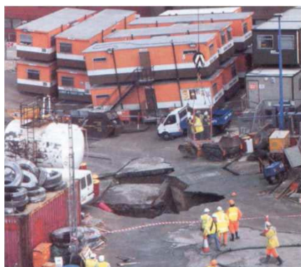
Aeroporto de Heathrow, Londres, 1994: início do colapso dos túneis, com formação de um buraco na superfície.
