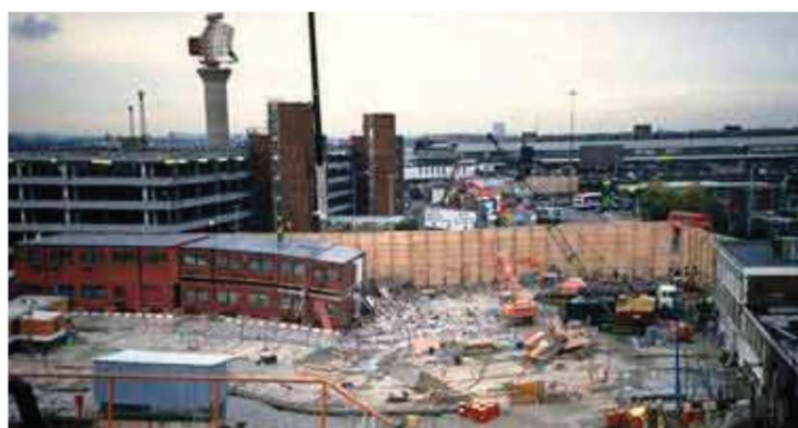
Vista geral da área afetada pelo colapso (Heathrow, 1994), após a demolição dos edifícios danificados.
