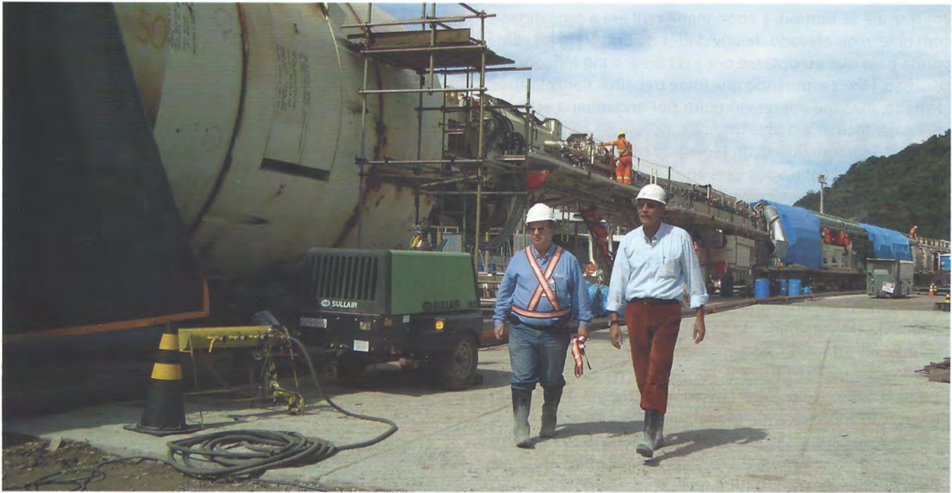
O engenheiro inspecionando o Tatução do túnel Gastau, o 1º TBM (Tunnel Boring Machine) em rocha do Brasil, localizado entre Caraguatatuba e Taubaté (SP)
