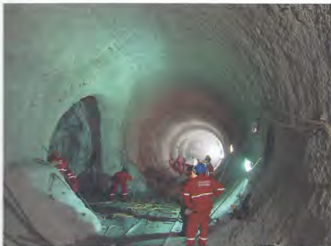
Abertura de túneis laterais para subida dos gasodutos, no túnel Gastau, uma das construções em que o engenheiro atuou
