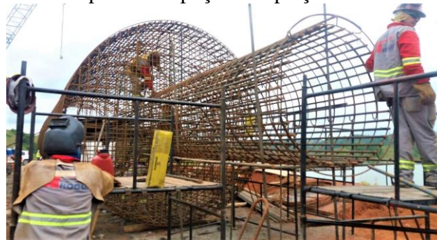
Figura 6 – Estrutura de armação em forma de cálice para o pino e base da fundação
