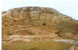
SITIO DONDE SE PRODUJO UN CORTE; NOTESE LA TUBIFICACION LONGITUDINAL
