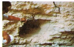
ACERCAMIENTO DE LA TUBIFICACION LONGITUDINAL
