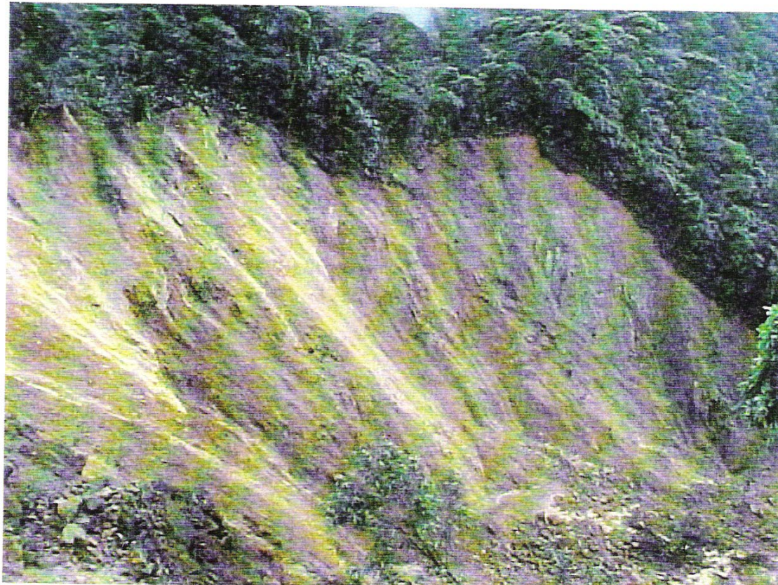
Escorregamento em andamento.
