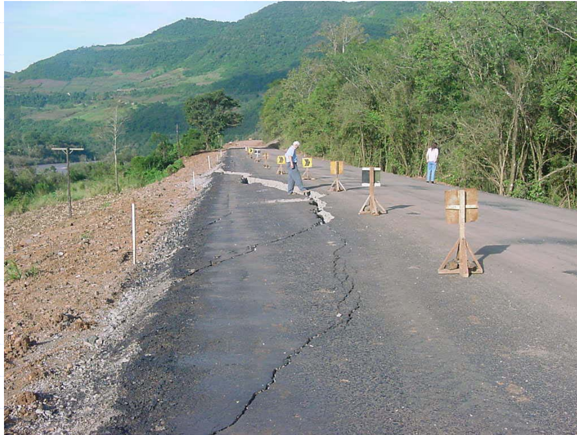
Trincas no pavimento e corpo estradal.
