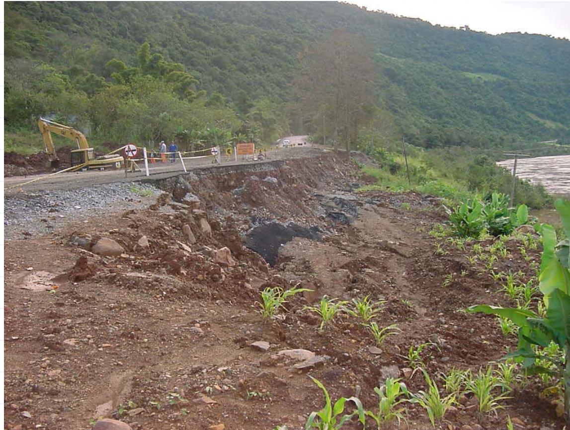
Movimentação do corpo do aterro rompido.
