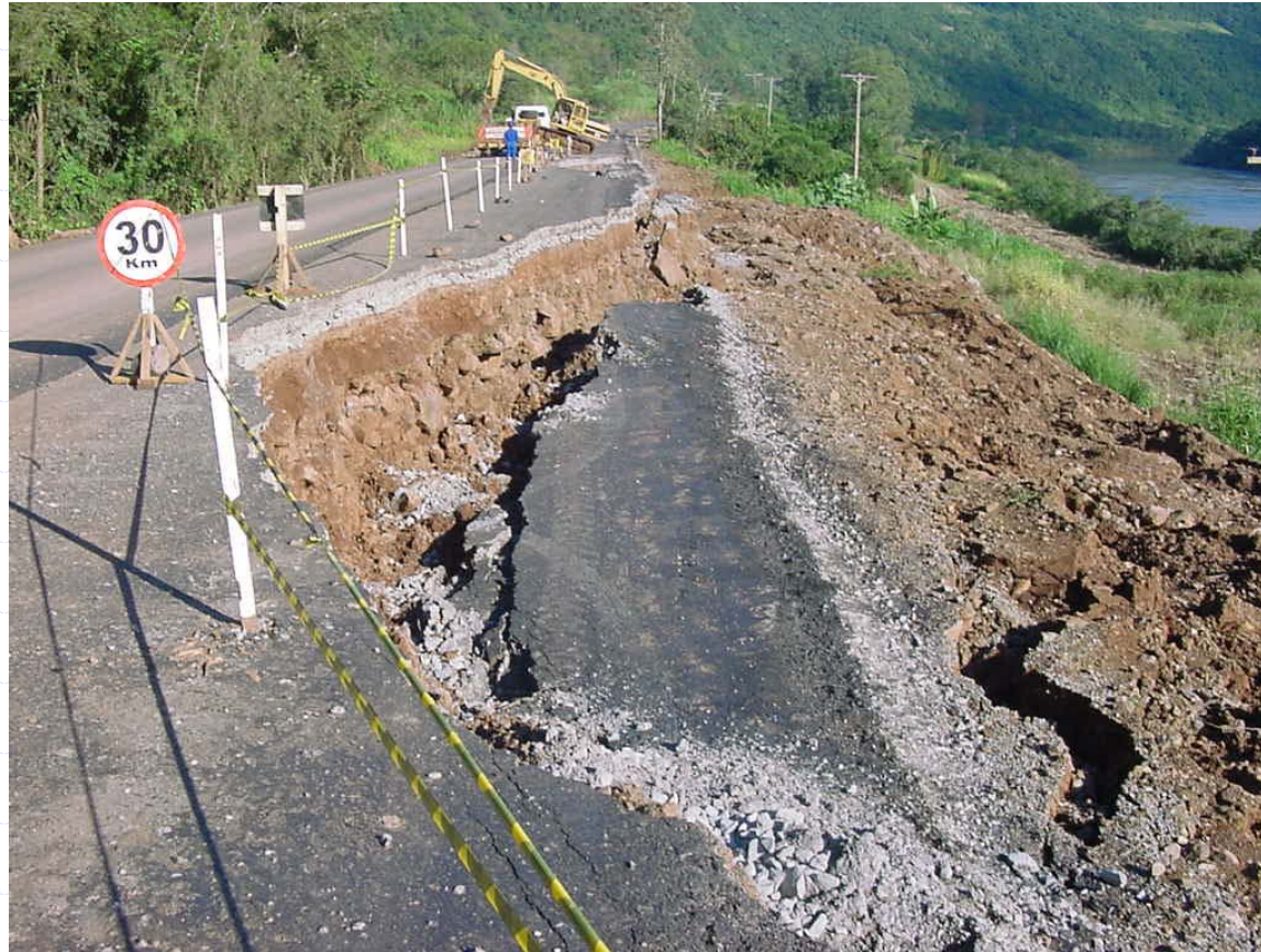
Ruptura do corpo estradal.
