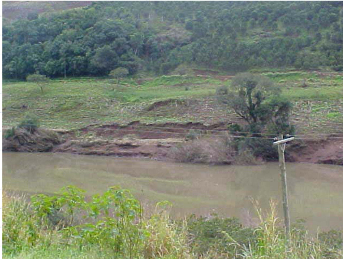
Ruptura do talude na margem oposta do rio.
