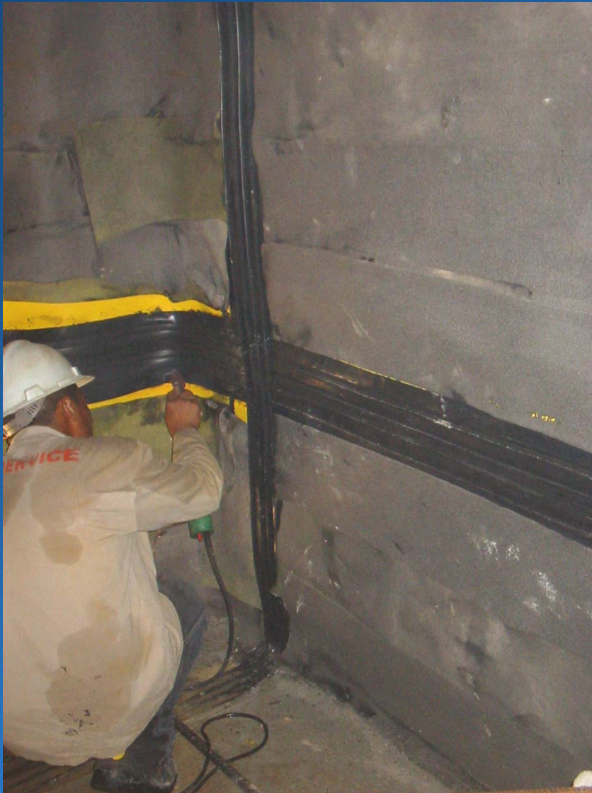
Figura 9 – Detalhe da impermeabilização sendo executada em uma das paredes no saguão da Pinacoteca (Dez/2003).
