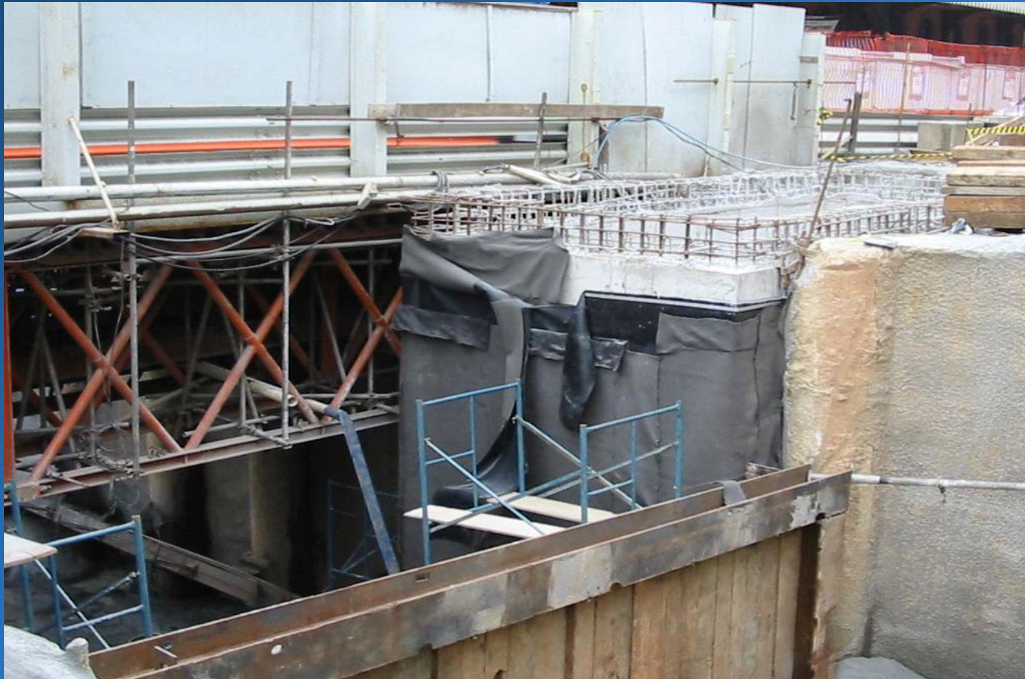
Figura 7 – Vala da Pinacoteca, com a manta colocada, e detalhe de ligação com chapa de alumínio, junto à superfície (Dez/2002).
