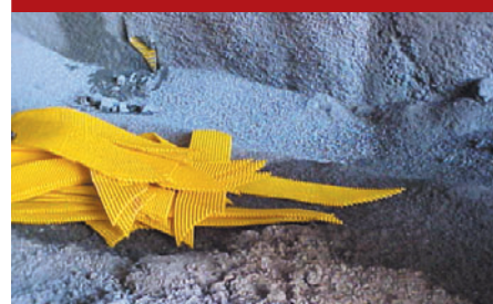
Geodrenos utilizados na drenagem da interface revestimento primário – revestimento secundário
