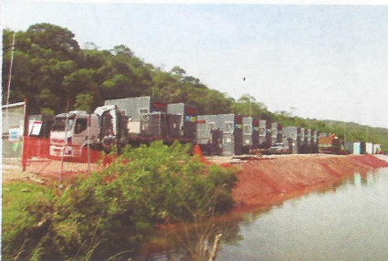
Foto 2 - Pátio de Geradores a Gás Natural (utilização inédita no Brasil)
