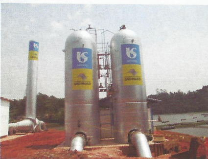
Foto 3 - Vista Geral dos Vasos de Pressão
