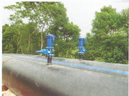
Foto 6 - Ventosas Tríplex-Função instaladas
