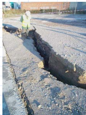
Colapso do Túnel Hull (Interceptor de Esgotos), Inglaterra, 1999 : Recalques excessivos e ruptura do maciço acima do túnel
