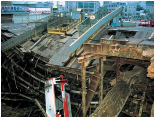
Colapso do Metro de Taegu (Cut and Cover), Coréia do Sul, 2000
