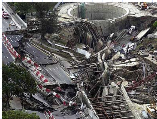
Colapso em Cut and Cover de Sistema Viário em Cingapura, 2004
