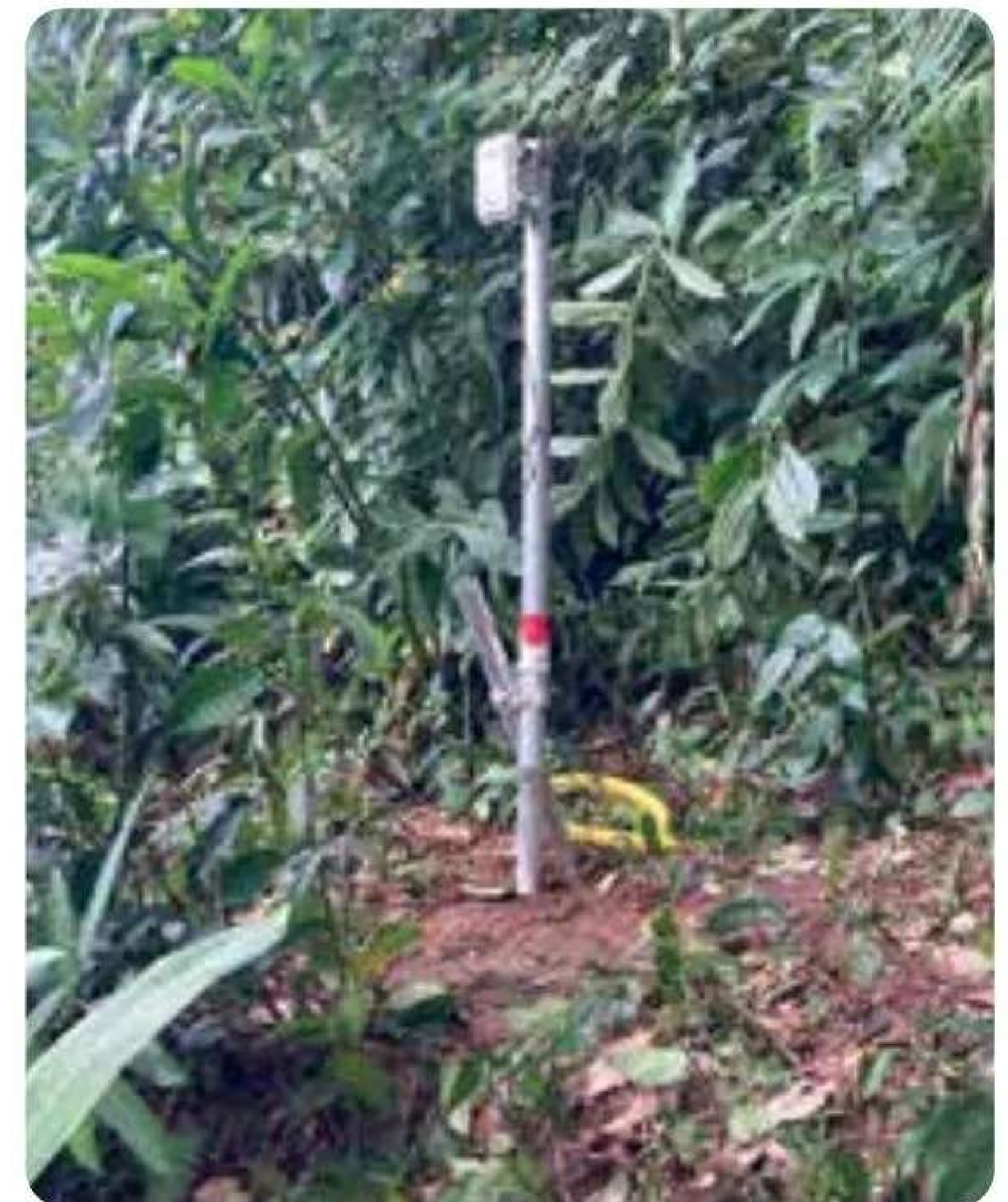
Sensores ficam enterrados no solo em estação de monitoramento do Sistema Kantaro da CKC instalada em encosta com alto risco de escorregamento na cidade de Praia Grande, na região metropolitana da Baixada Santista
