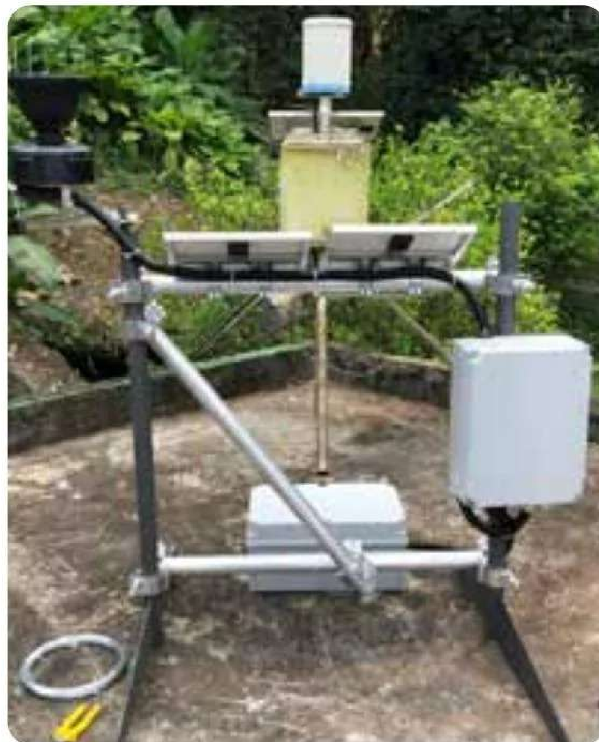
Pluviômetro e painéis fotovoltaicos são alguns dos instrumentos que compõem as estações de recepção e transmissão de dados do Sistema Kantaro da CKC, instalado em encosta com alto risco de escorregamento na região metropolitana de São Paulo
