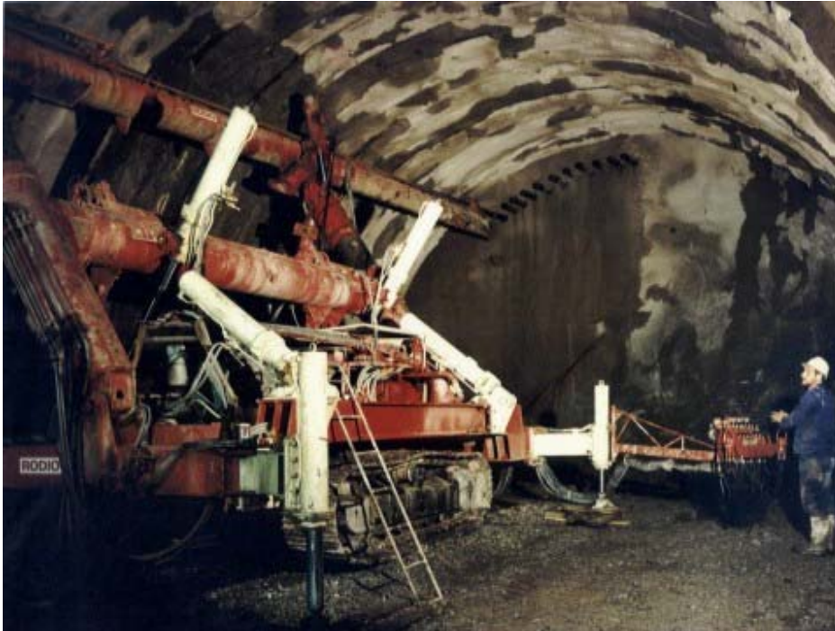
Figura 11: Guarda Chuva de Jet grouting em Material de Talus para Túnel Rodoviário - Karintha, Áustria 1986
