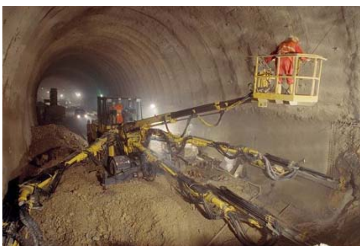
Figura 3: Perfuratriz tipo “Jumbo” Automática, usada em variante do Túnel de Graz, Áustria 2001.
