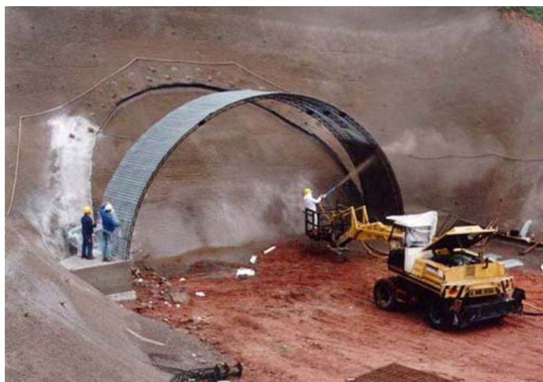
Figura 27: Emboque com Portal em Concreto Projetado no Túnel de Rota Alternativa B27- Schürzeberg, Alemanha 1991
