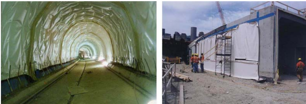
Figura 28a: Impermeabilização em Membrana usada na Seção F6b do WMATA – Metrô de Washington, DC 1995
