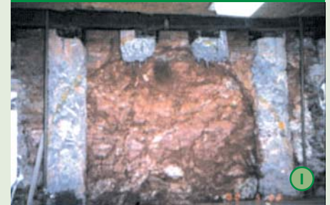
Vista frontal do emboque do túnel, mostrando viga metálica de transferência de carga e estacas cortadas para início da escavação em NATM
