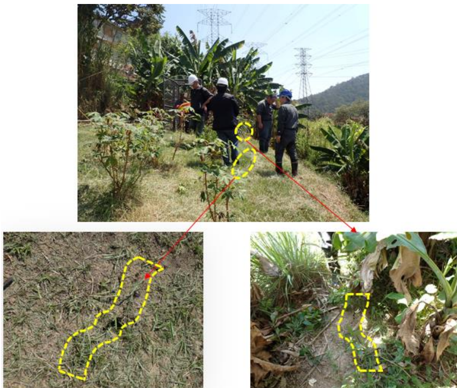
Figura 10 – Trincas observadas próximas ao sensor em visita técnica realizada
