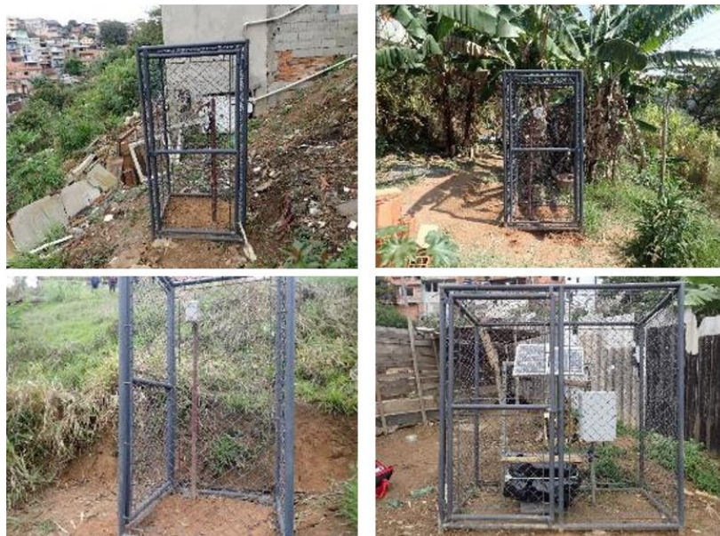
Figura 7. Sensores instalados no monitoramento piloto.
